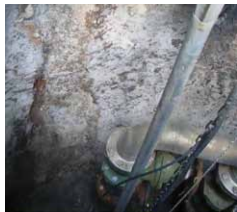
Wpływ H_2S na beton
