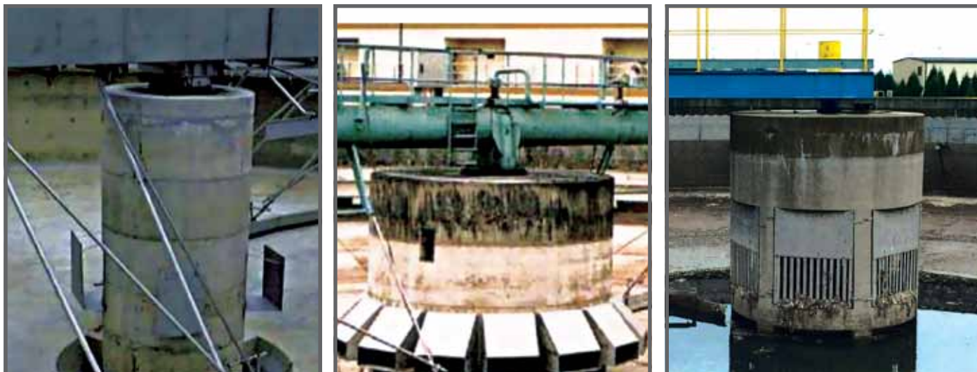
Typowe - stałe kolumny napływu ścieków do osadników
