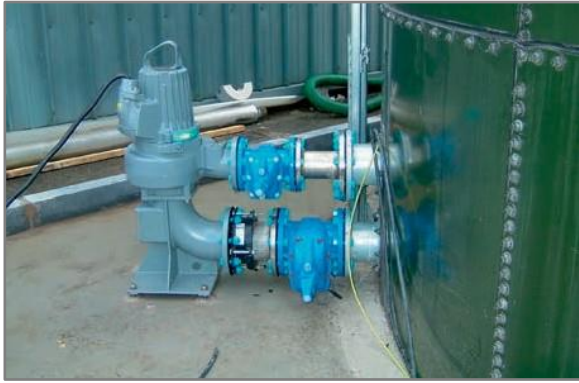
Na zewnątrz zbiornika: pompa Flygt N mieszadła strumieniowego. Orurowanie ze stali nierdzewnej mocowane do zbiornika zapewnia zasysanie i tłoczenie cieczy.
