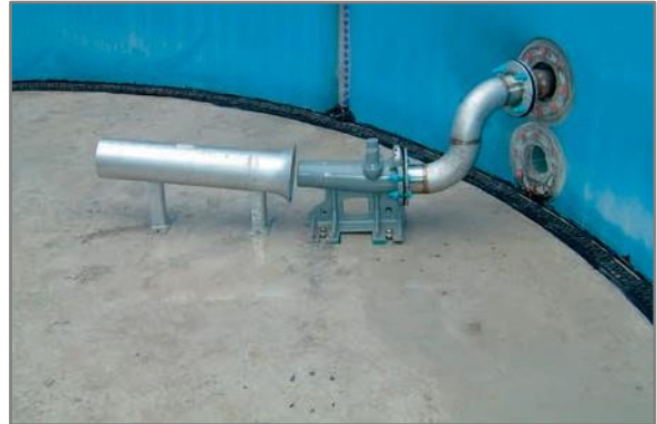
Wewnątrz zbiornika: tu usytuowane są: dysza wylotowa i rura eżektora, generujące cyrkulacyjny przepływ masowy, powodujący homogenizację i utrzymywanie mieszanego osadu w zawieszeniu.
