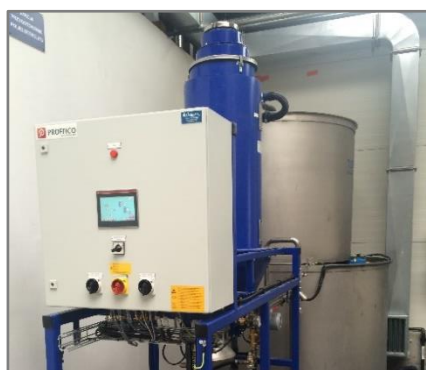
Stacja dozowania flokulantu
