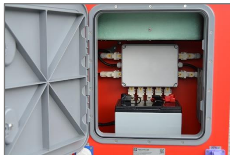
Komora elektryczna mieści w sobie akumulator, inwerter i prostownik.
