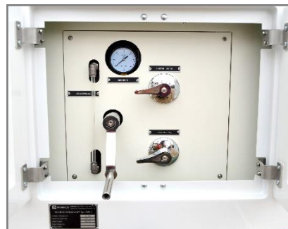
Panel sterowniczy z wodowskazem, manometrem zaworem wody oraz CO 2 .
