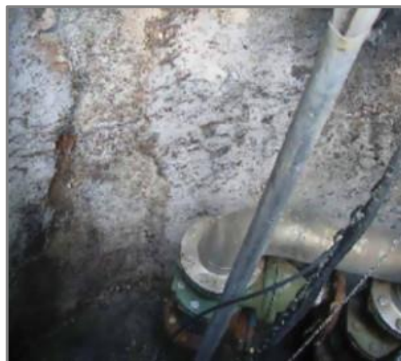
Wpływ siarkowodoru na beton
